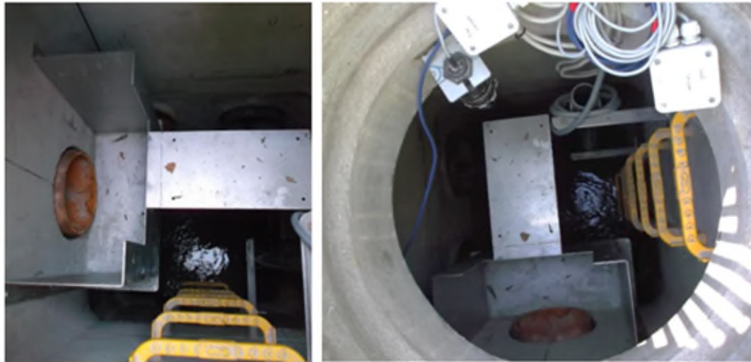
Figure 6 - Exemple de seuil calibré avec plaque de contrôle du zéro conforme aux exigences de l'AERMC
