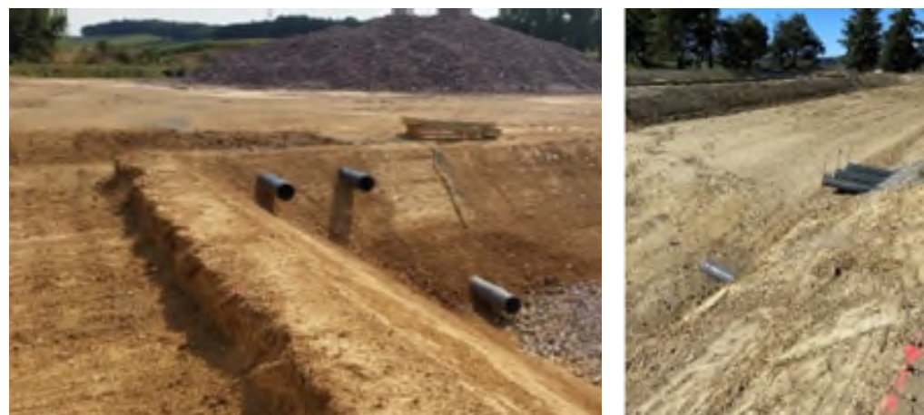
Figure 19 - Canalisations entrée / sortie en attente
