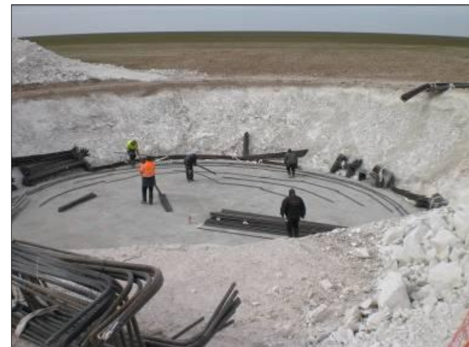
Photo 161 : Exemple de fondations à remettre en état (Source : BEJC)
