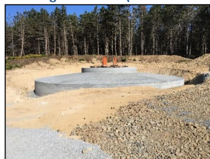
Photo 10 : Fondation non remblayée (Source : Artifex 2018)
