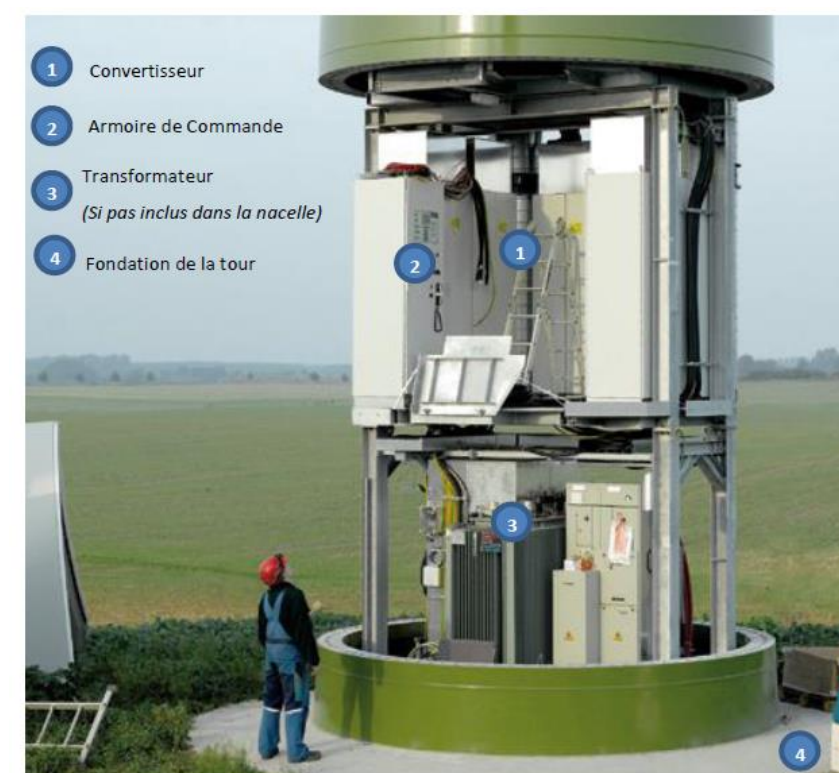
Figure 5 : Transformateur inséré dans le mât (Enercon)
