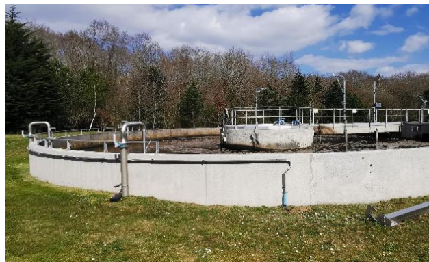
Photo 2 : Bassins d'aération (source : B3E ; 24/11/2005)
