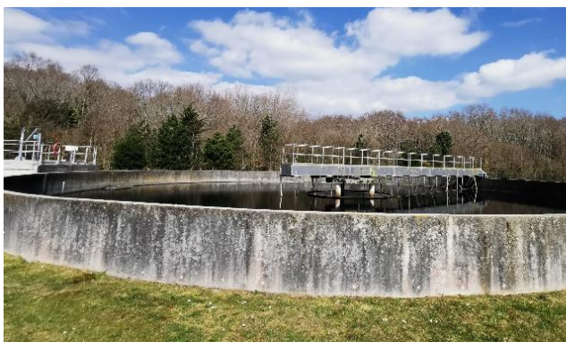
Photo 3 : Clarificateur (source : B3E ; 24/11/2005)
