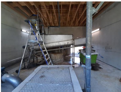
Photo 1 : Dégrilleur (source : B3E ; 15/04/2021)
