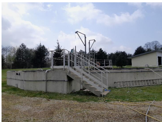
Figure 8. Bassin d'aération (Source : ©Biotope, 29/03/2022)
