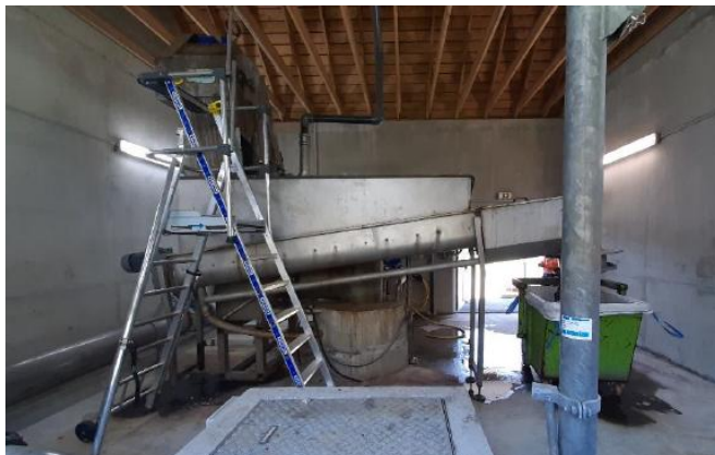
Figure 6. Dégrilleur (Source : ©B3E, 15/04/2021)
