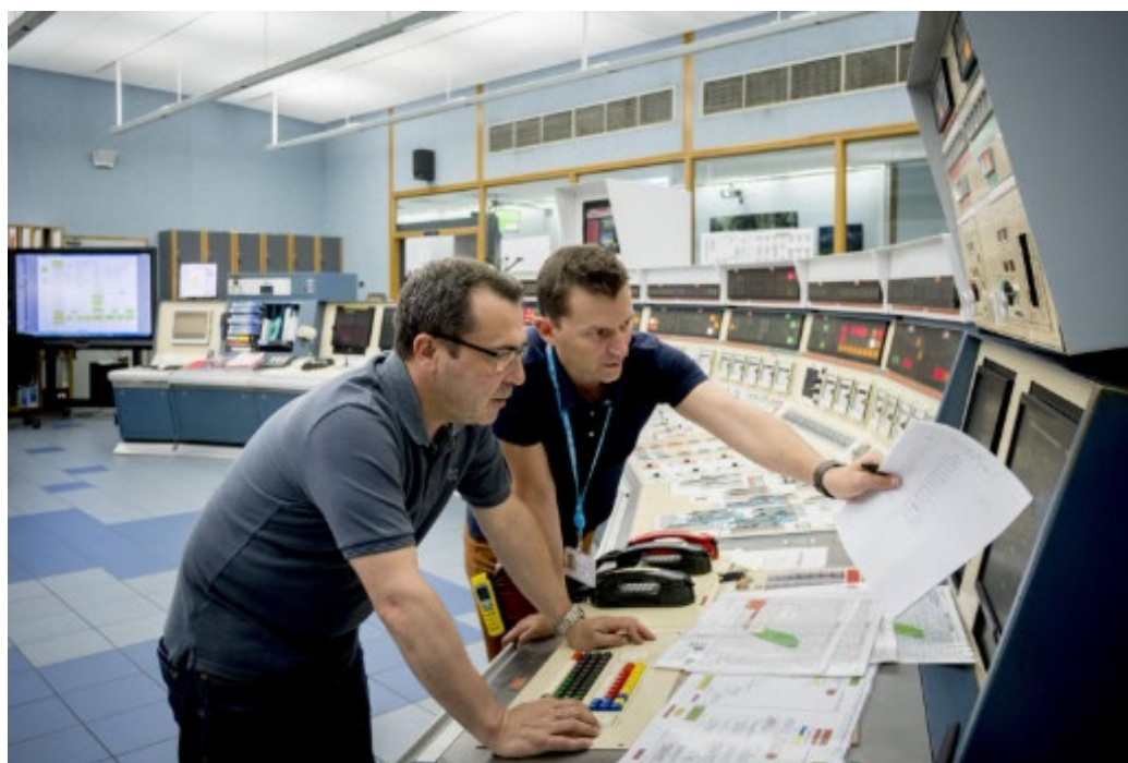
Figure 19. Salle de commande d'un réacteur 900 MWe
