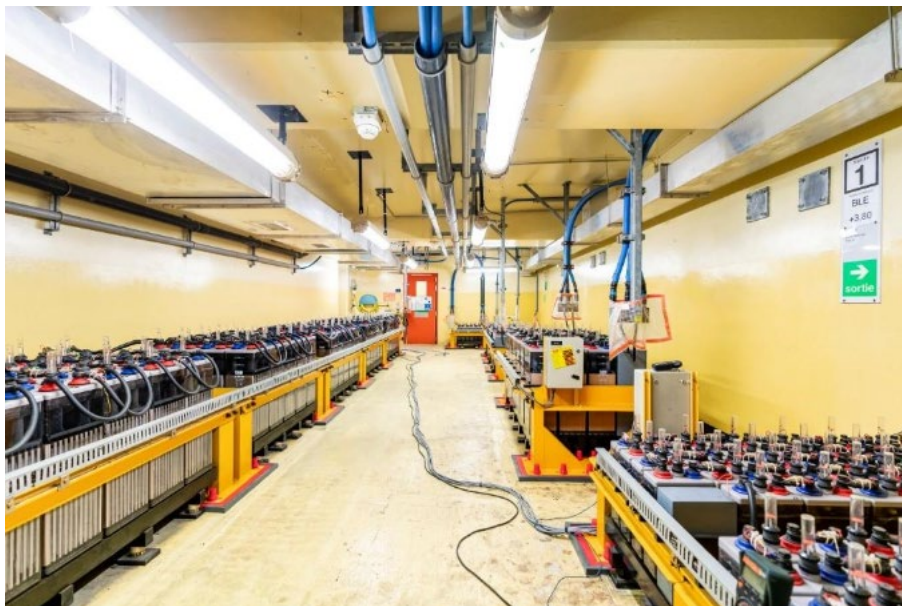
Figure 6. Photo des locaux contenant les batteries
