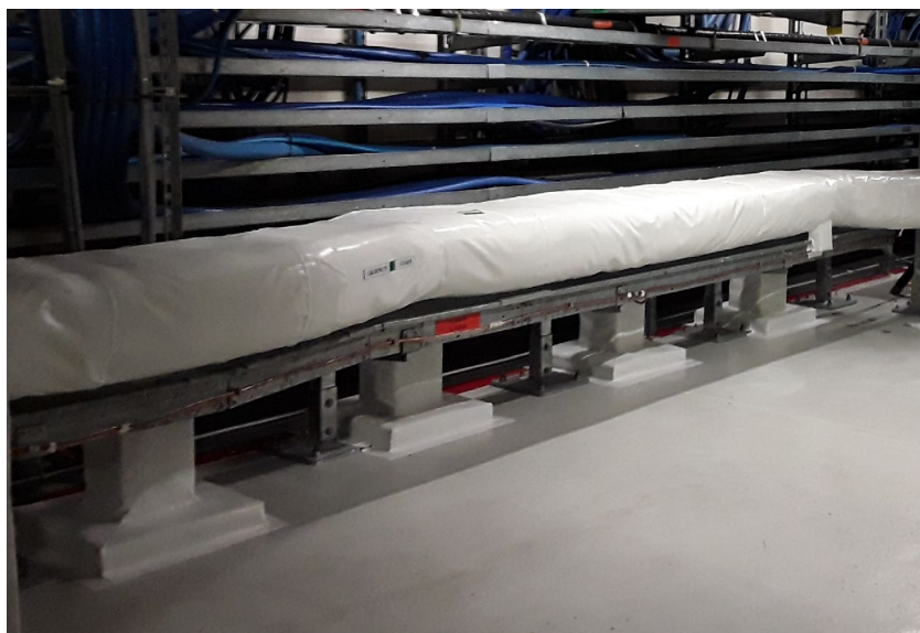
Figure 4. Exemple de protection de chemin de câbles
