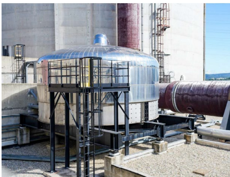
Figure 11. Photo du dispositif d'éventage et de filtration de l'enceinte (filtre U5)
