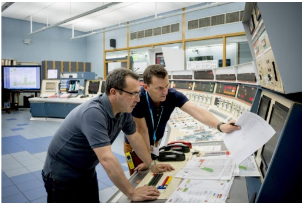
Figure 19. Salle de commande d'un réacteur 900 MWe
