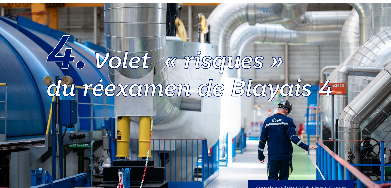
Centrale nucléaire EDF du Blayais, Gironde © Copyright EDF – Yohan Espiaube
