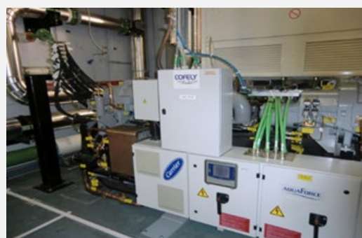
Nouveau groupe froid (+ 50% de capacité frigorifique)
