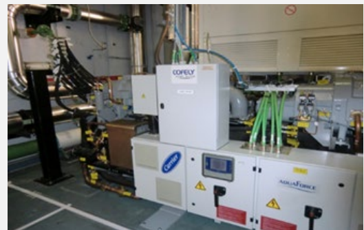
Nouveau groupe froid (+ 50% de capacité frigorifique)
