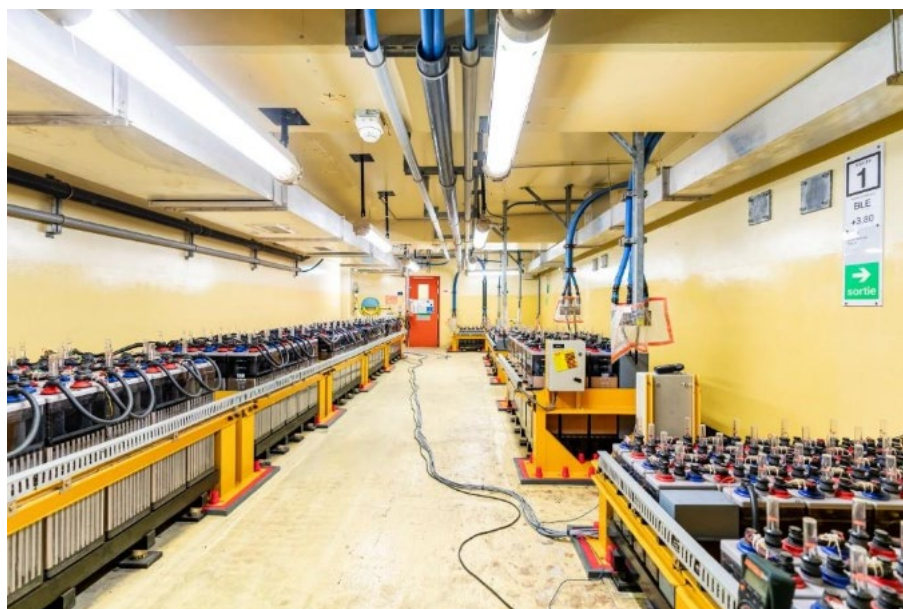
Figure 6. Photo des locaux contenant les batteries
