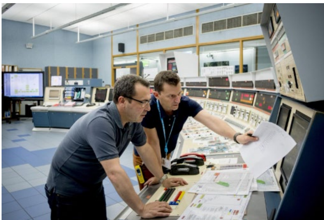
Figure 20. Salle de commande d'un réacteur 900 MWe
