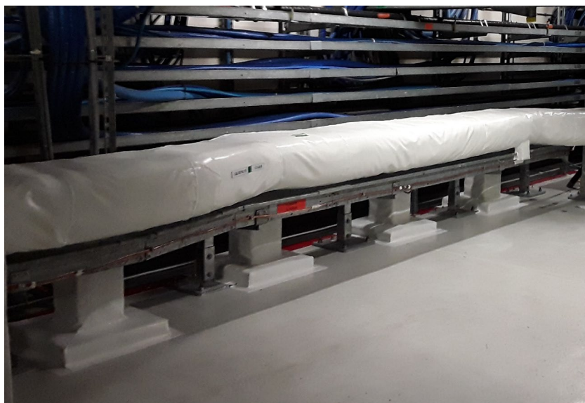
Figure 4. Exemple de protection de chemin de câbles
