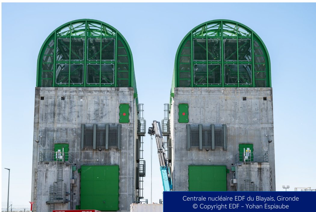
Figure 8. Photo de deux Diesels d'Ultime Secours (DUS) de 3 MWe
