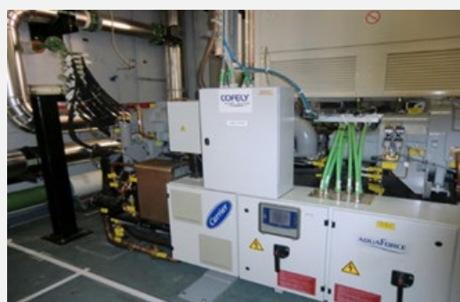
Nouveau groupe froid (+ 50% de capacité frigorifique)
