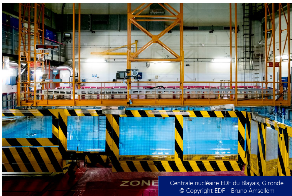
Figure 12. Photo d'une piscine d'entreposage du combustible au sein du bâtiment combustible
