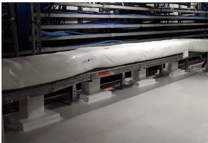
Figure 5. Exemple de protection de chemin de câbles
