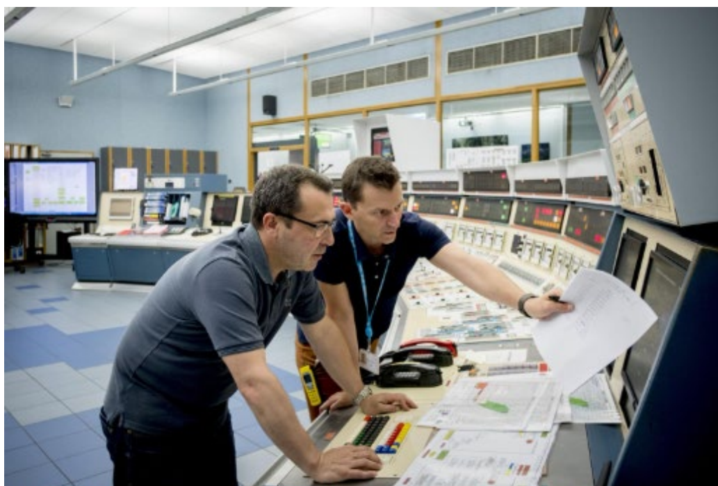
Figure 20. Salle de commande d'un réacteur 900 MWe
