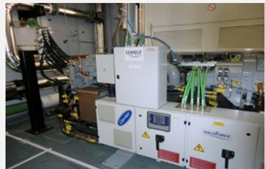
Nouveau groupe froid (+ 50% de capacité frigorifique)
