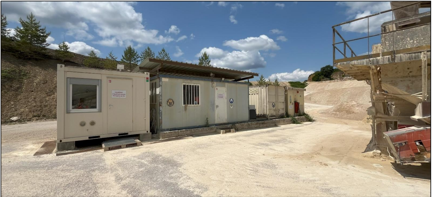
Photographie 1 : e gauche à droite, c'est le poste de commande, le local électrique, le système de rabattage des poussières et le transformateur électrique
