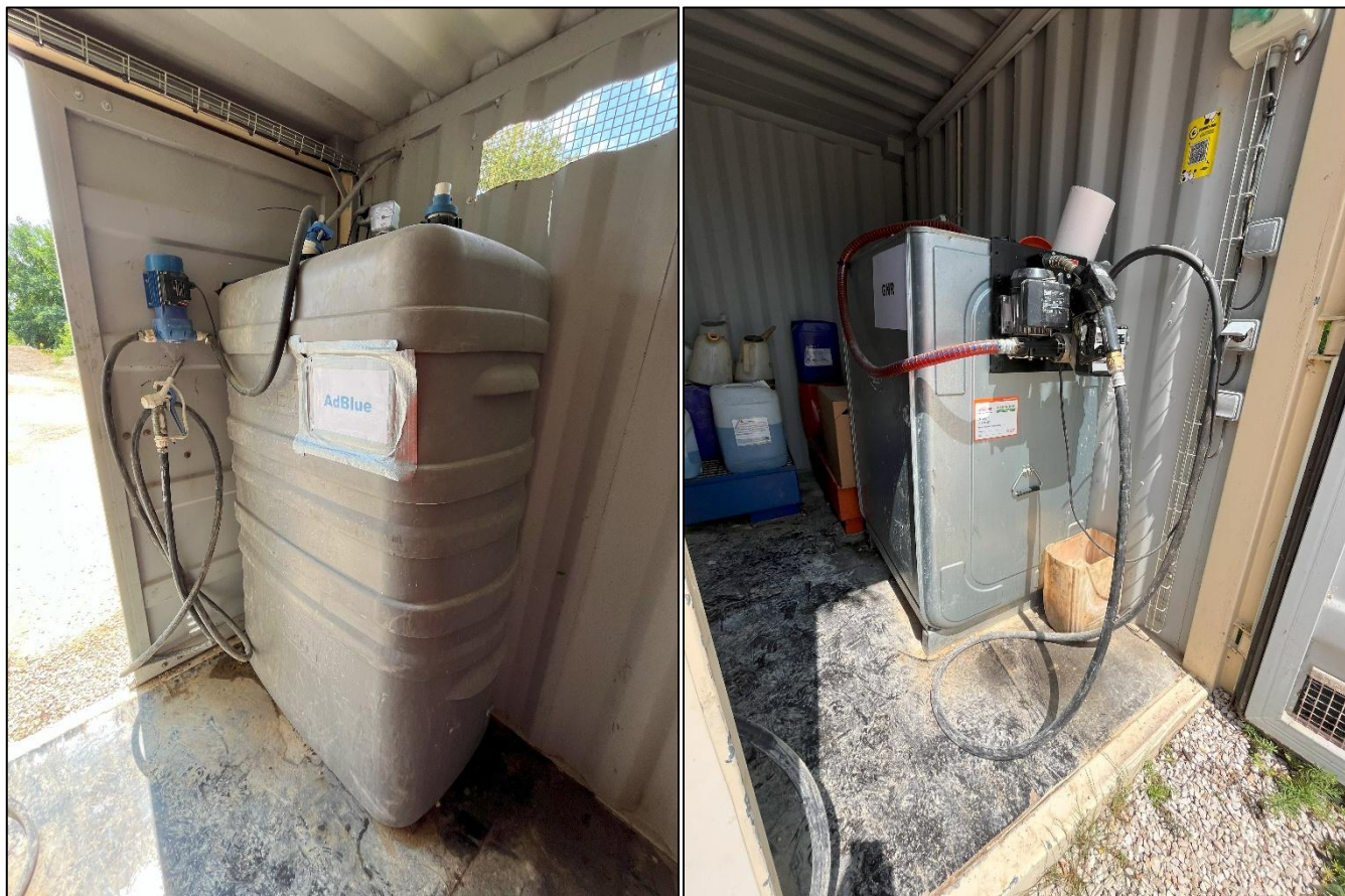
Photographie 2 : Stockage de GNR et AdBlue
