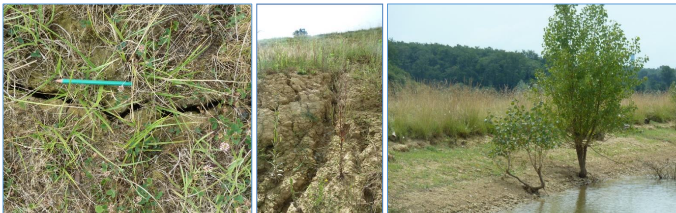
Figure 3. Exemples de désordres pouvant être relevés sur un barrage
