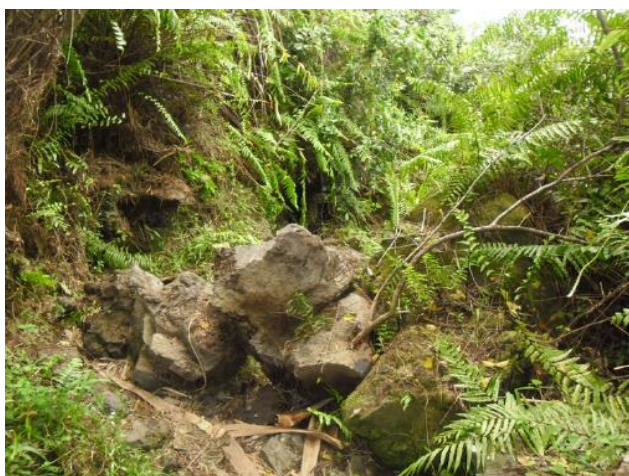
Chute de blocs – Sentier du Vieux Port (2018)
