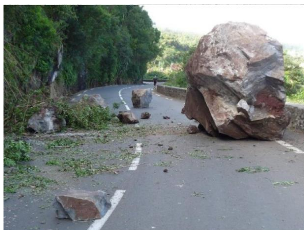
Chute de blocs, Basse Vallée – RN2 (2010)
