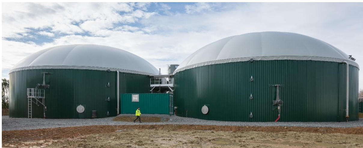
Figure 3 : Exemple de digesteurs (Source : ENGIE BIOZ)
