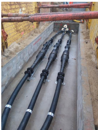
Chambre de jonction
