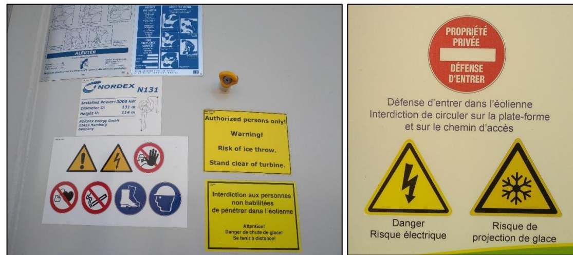
Figure 38 : Panneaux d'information sur la possibilité de formation de glace (Source : NCA Environnement)
