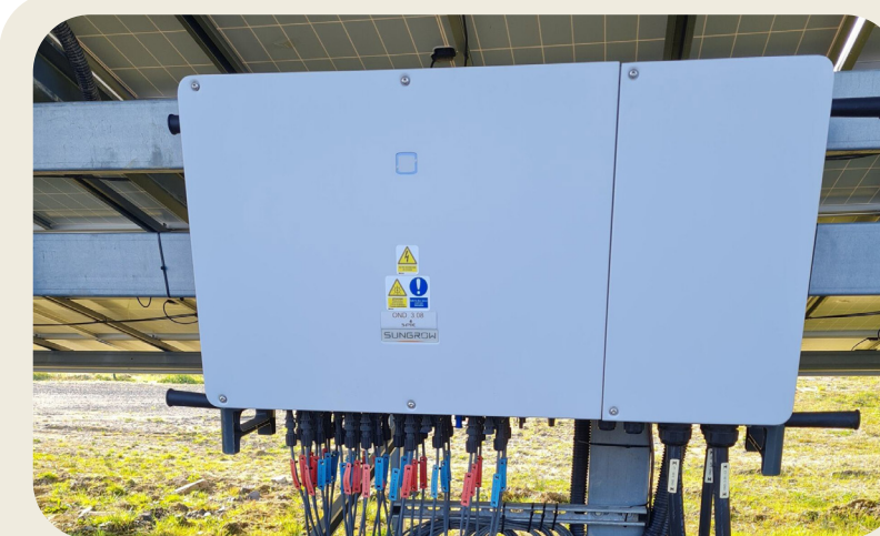
Exemple d'un onduleur sur une centrale sol TSE
