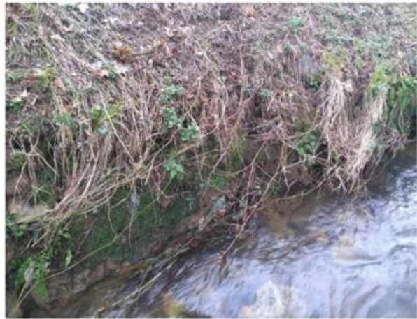
Profil de berge au niveau du tronçon en pied de la RD216 avec matériaux alluvionnaires défavorable à la présence de gîte
