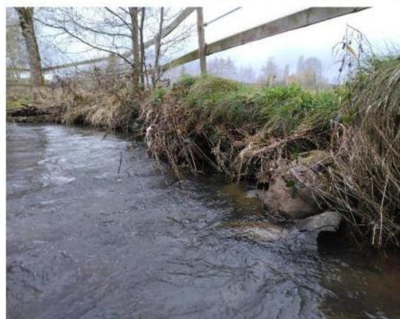
Vue d'un virage avec un berge en rive gauche plus hétérogène avec un léger sous-cavage et blocs apparents sur certains secteurs liés au phénomène d'érosion.
