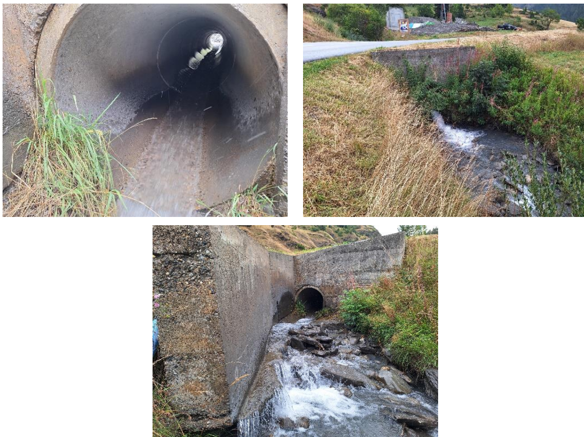
Photographie 9 : Buses infranchissables pour la faune piscicole
