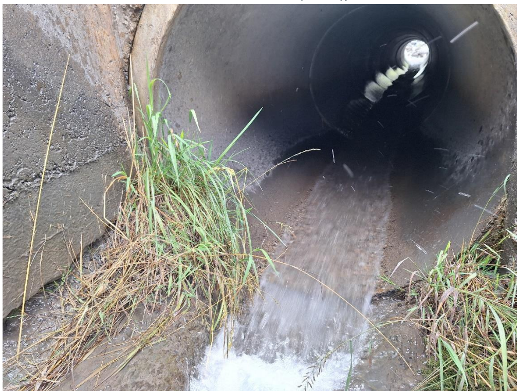
Photographie 11: Buse infranchissable
