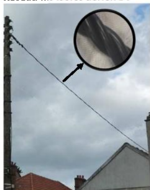
Réseau fils isolés aérien BT
