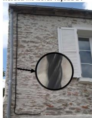
Réseau fils isolés façade BT
