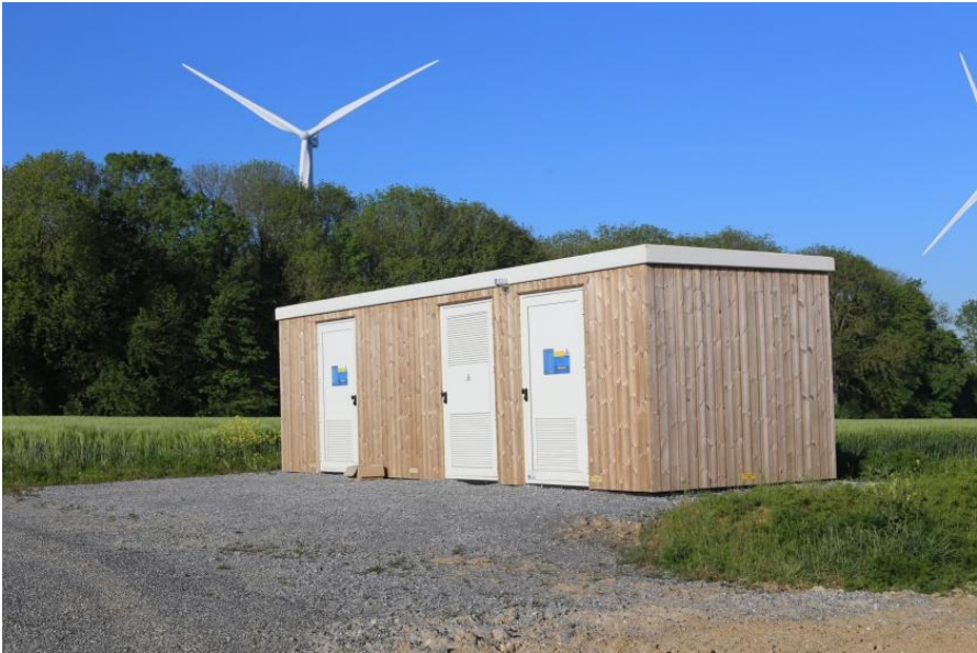
Figure 234 : Exemple d'un poste de livraison avec platelage bois Source : AEPE Gingko
