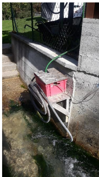
Photographie 4 : Pompage et crépine sur la dérivation en RD
