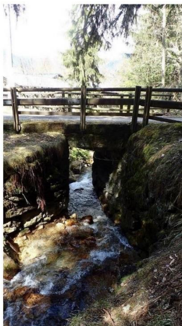
Figure 10 : Photographie de la réduction de la section sous le pont de la route de la Jairaz
