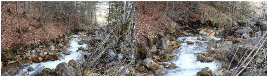
Figure 12 : Photographies des érosions de berge de rive gauche sur le torrent de la Rosière Source : SIGosphère
