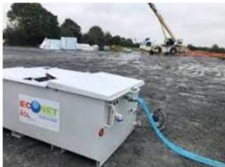
Système de traitement des eaux de chantier
