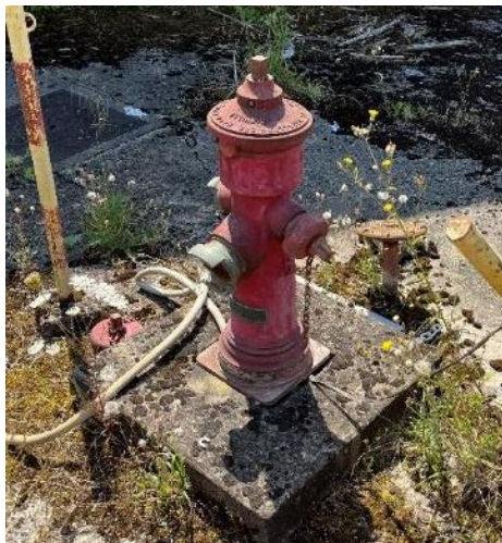
Photo 37 : PEI existant sur le site
