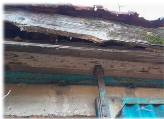
Photo 24 : Avant-toit de la maison abandonnée au nord-est (cf. Carte 11), potentiellement favorable au gîte (A. Garry, Écosphère)
