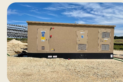
Exemple de poste de livraison
