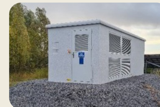
Exemple de poste de transformation
