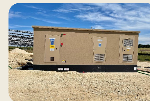
Exemple de poste de livraison
