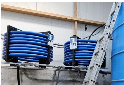
Photo : Vue des pré-refroidisseurs tubulaires
