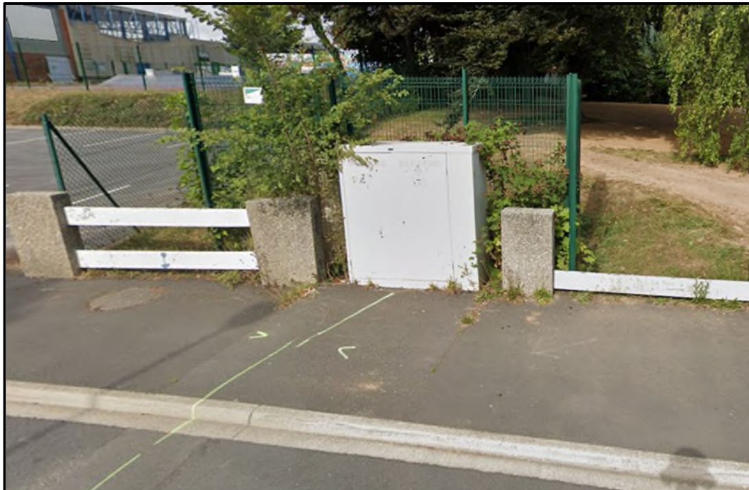
Figure 9. Poste d'alimentation en gaz naturel (source : CORIANCE)
