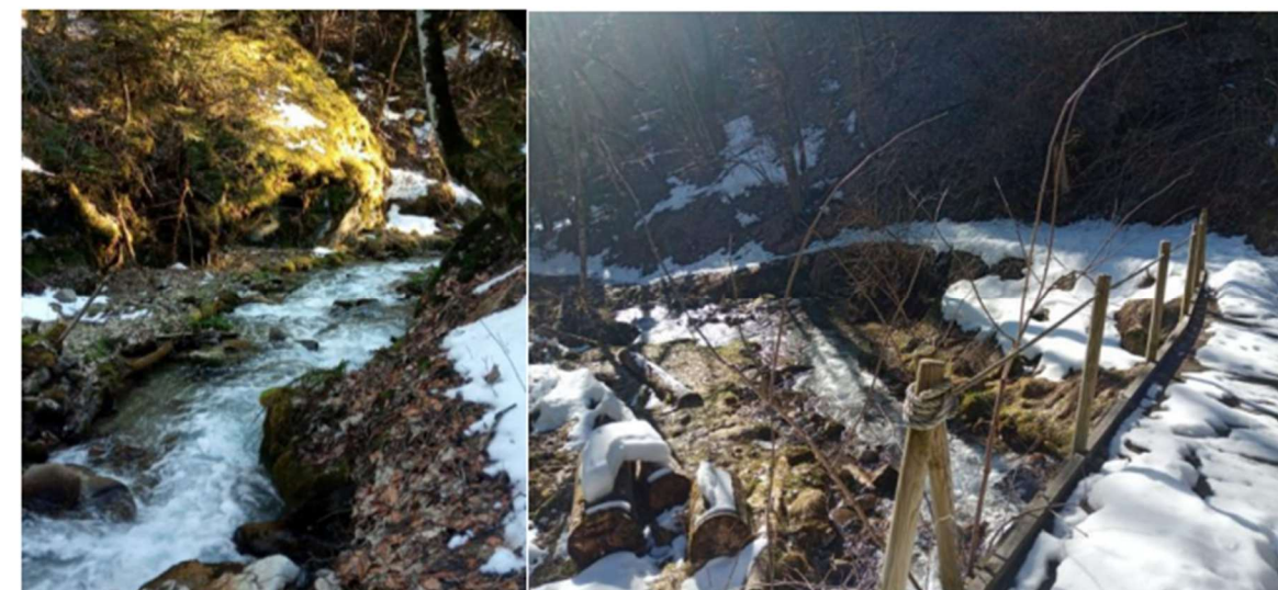
Figure 51 : berges du secteur de la passerelle
