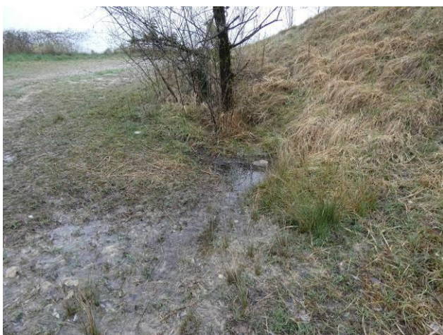
Hors zone, un suintement en bordure de chemin
