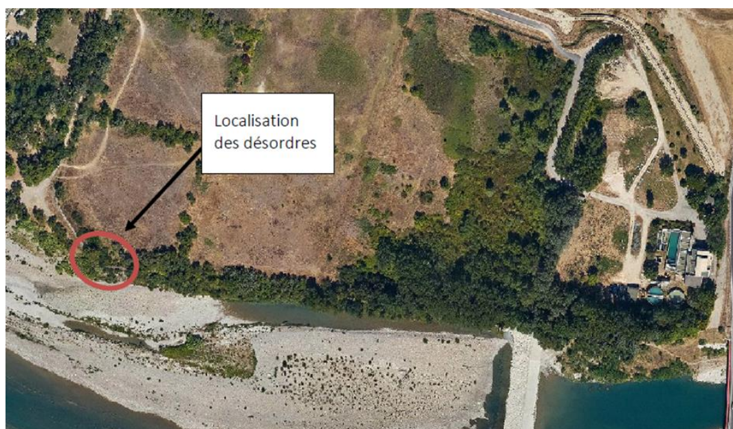
Figure 137 : Localisation des désordres observés au droit de la digue historique de Tarteau (source : SMAVD, 2023)
