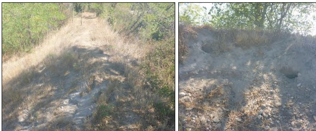
Talus aval végétalisé (à gauche) et présence de terriers sur talus amont (à droite)
