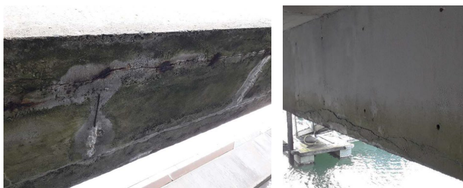
Figure 2-16 - Désordres observés au niveau des poutres
