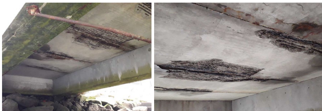
Figure 2-15 – Désordres observés en sous face du tablier
