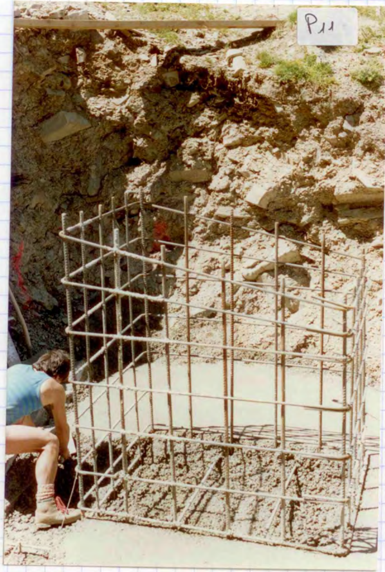
Éboulement en cours de consolidation
