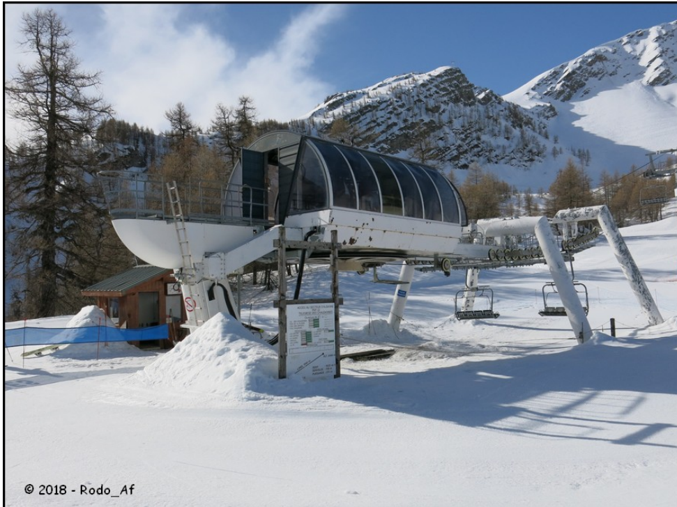
FIGURE 1: GARE G1 TSF 4 LES CHAUDANNES
