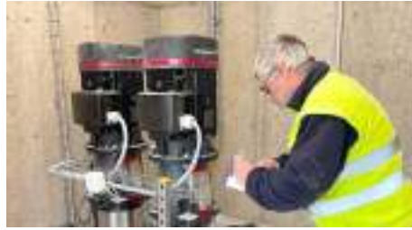
Les deux groupes électropompes de la station de pompage du Puy de la Buse.
