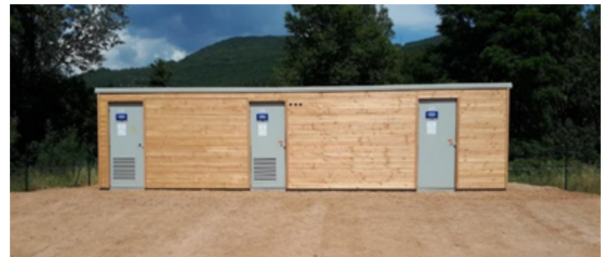
Fig.9 Exemple de poste de livraison
