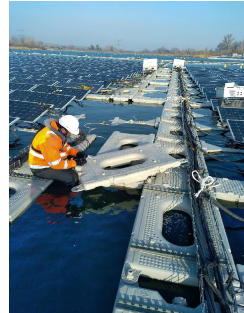
Fig.32 Opération de maintenance réalisée par Akuo Energy Maintenance
