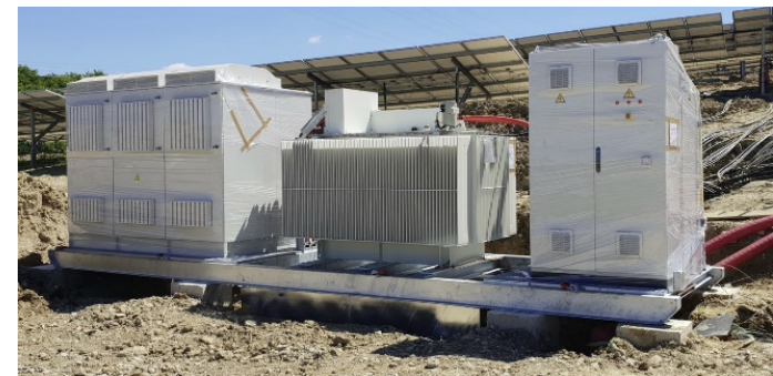
Fig.31 Poste de transformation sans mesure d'intégration paysagère
