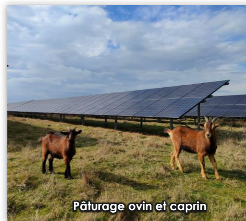
Panneaux fixes au sol – Lherm (31) Source : Akuo
