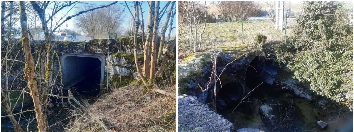
Figure 4 - les ouvrages limitants de la zone de stockage : ouvrage amont (cadre 2x 2, gauche) ; ouvrage aval (buse Ø2000+ Ø1000, droite)
