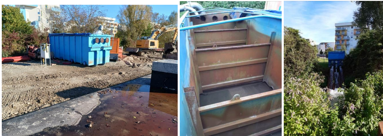
Figure 10 : Exemples de dispositifs de prétraitement avant rejet des eaux de rabattement de nappe
