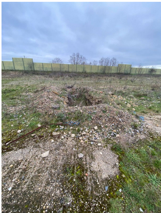
Figure 8 : Ancienne fouille non rebouchée.
