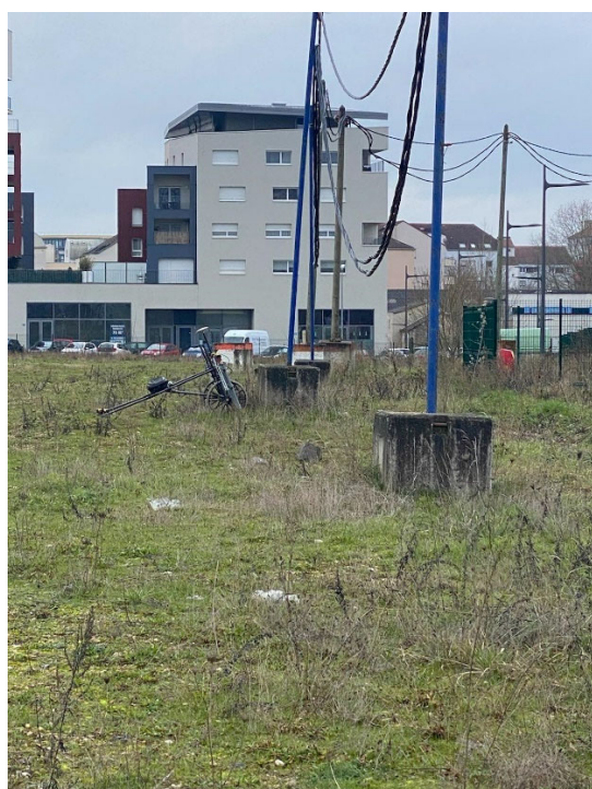
Figure 14 : Ligne électrique sur pilier en béton.
